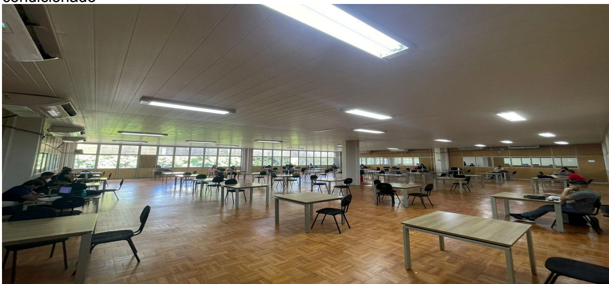
Figura 4 - Salão de estudos em grupo BCCP após instalação dos aparelhos de ar condicionado
